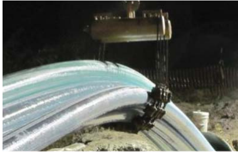
National Grid Malden, MA
